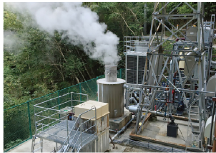
下田温泉バイナリー発電所
