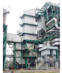
排煙脱硝装置
