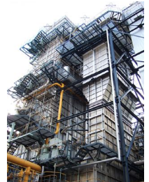
排煙脱硫装置
