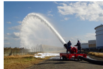
大容量泡放水砲（大分製油所）
